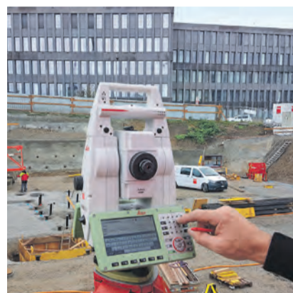
Bei KOPA kommen verschiedene Monitoring-Methoden zum Einsatz.
